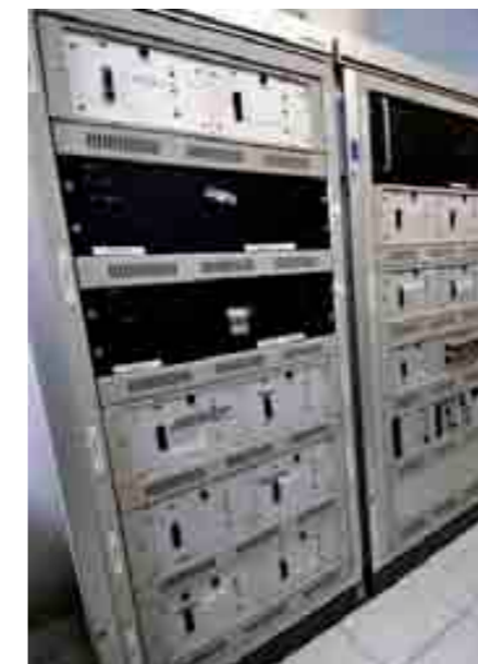
– Die Verstärker im Keller der Gemeindeverwaltung sind schon etwas altersschwach.
